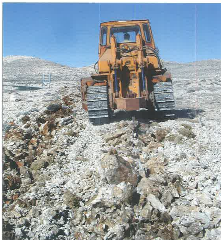
Slika 12. Riperač u pripremi tla za pošumljavanje Figure 12 Ripper preparing the soil for afforestation
