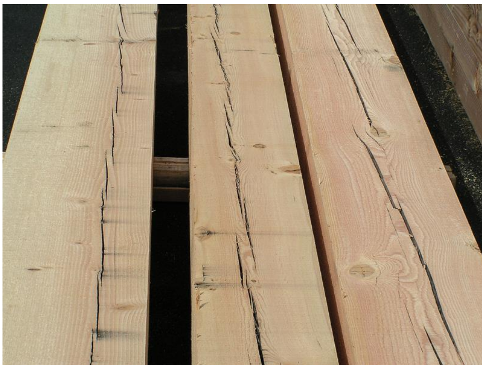
Slika 13 Pukotine na drvu
