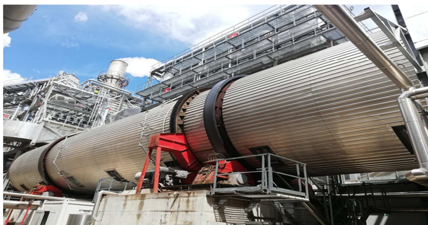
Slika 4. Rotirajuća bubanj sušionica
