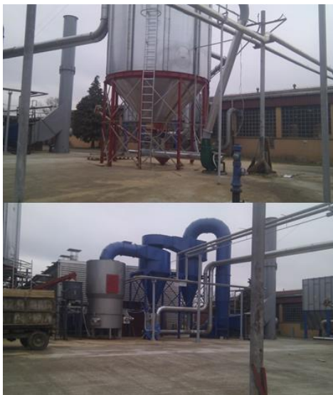
Slika 19. Silos za piljevinu i postrojenje za brikete
