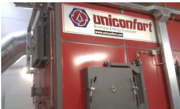
Slika 13. Unicomfort kotlovnica prednja stranja
