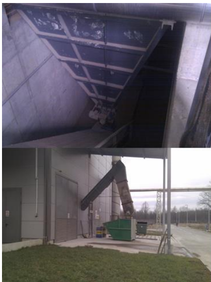
Slika 12. Otpadni sustav energane gdje odlazi neiskorišteni pepeo
