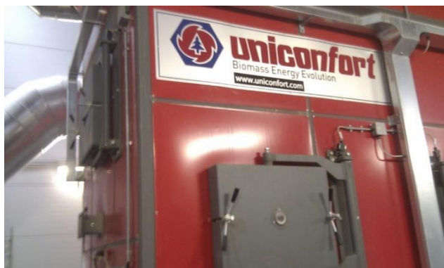
Slika 13. Unicomfort kotlovnica prednja stranja
