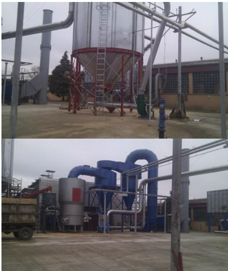
Slika 19. Silos za piljevinu i postrojenje za brikete
