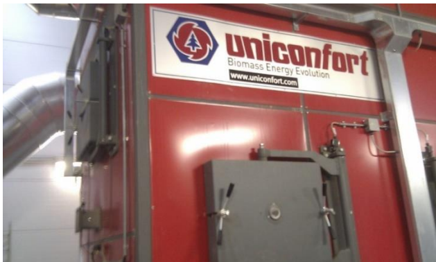
Slika 13. Unicomfort kotlovnica prednja stranja
