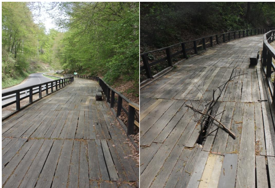
Slika 30. Drvena konstrukcija i pod na određenim dijelovima staze u relativno lošem stanju zbog utjecaja iznimne vlage predstavljaju određenu vrstu opasnosti za posjetitelje (foto: Tikvić, 2016.)
