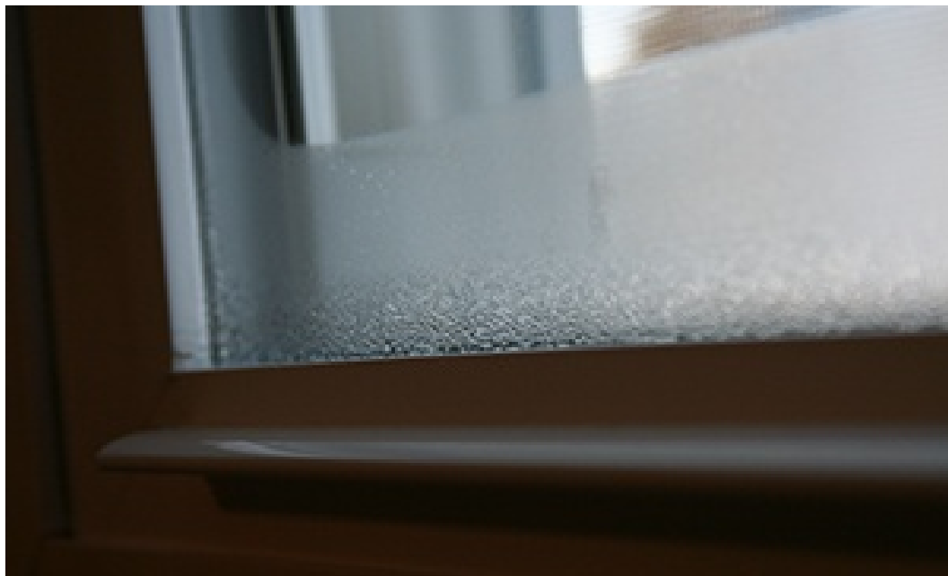
Slika 25. Kondenzacija vodene pare na prozoru (Anonymus 9, 2016h)
