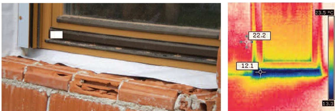
Slika 24. Primjer nepravilne ugradnje prozora (Veršić, 2014)
