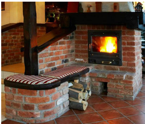
Slika 39. Komunikacijska jedinica s pripadnim kaminom (Izvor: http://www.selectbox.hr/place/restoranzaboky/ )
