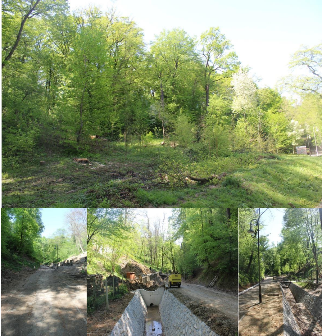
Slika 38. Radovi na kanaliziranju potoka, uređenje same trase šetnice te okolnog terena u suradnji Hrvatskih šuma i Hrvatskih voda (foto: Tikvić, 2016.)
