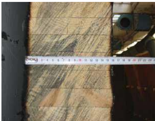
Slika 8. Lamelirani nosač izgubio 4 cm nakon požara http://drvene-konstrukcije.hr/karakteristike-llid/
