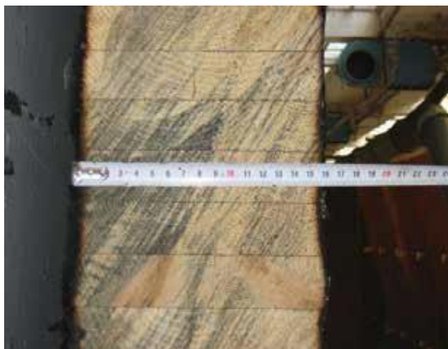
Slika 8. Lamelirani nosač izgubio 4 cm nakon požara http://drvene-konstrukcije.hr/karakteristike-llid/
