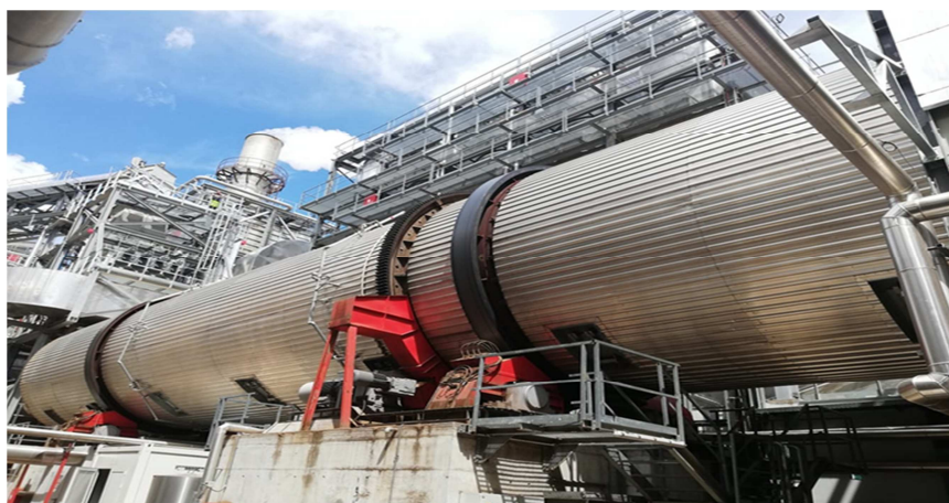
Slika 4. Rotirajuća bubanj sušionica
