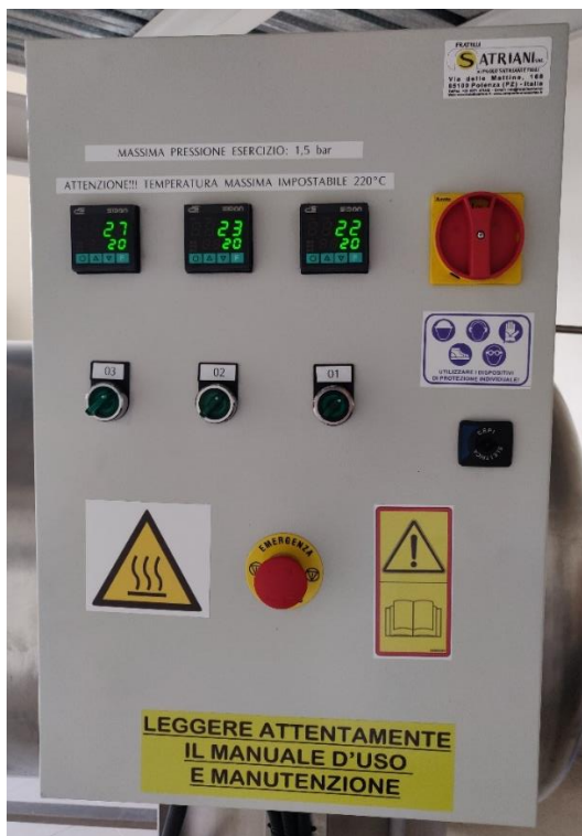
Slika 7: Kontrolna ploča za tri grijača (fotografija: Kvakan, 2022.)
