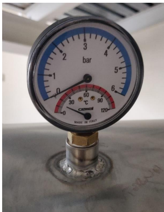
Slika 6: Termometar/barometar ugrađen u kotao (fotografija: Kvakon, 2022.)
