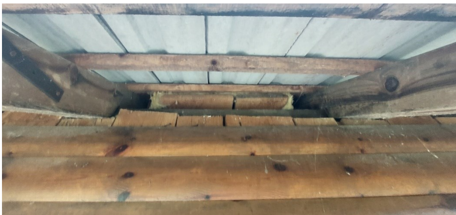
Slika 15. Snimka - detalj spoja pročelja i potkrovlja
