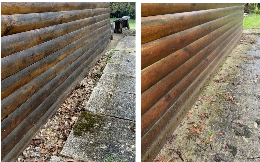
Slika 17. Snimka – detalj donjeg djela pročelja uz tlo. Elementi pročelja su u doticaju s tlom. Betonski opločnici su odmaknuti od drva (lijevo), drvo u kontaktu s betonom (desno).
