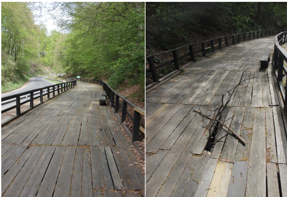
Slika 30. Drvena konstrukcija i pod na određenim dijelovima staze u relativno lošem stanju zbog utjecaja iznimne vlage predstavljaju određenu vrstu opasnosti za posjetitelje (foto: Tikvić, 2016.)
