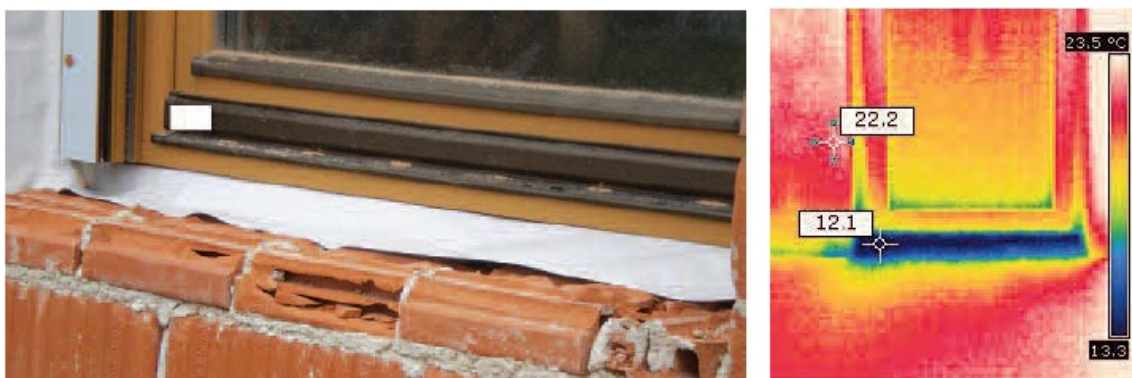
Slika 24. Primjer nepravilne ugradnje prozora (Veršić, 2014)
